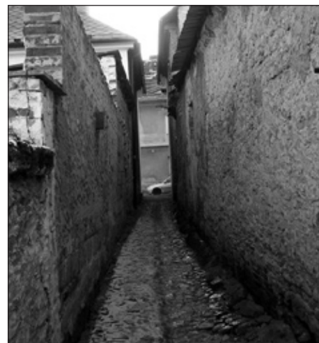
Poškozené dláždění v Poštovní ulici
