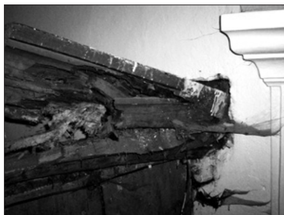
Detail dřevěných částí kostela napadených dřevomorkou
