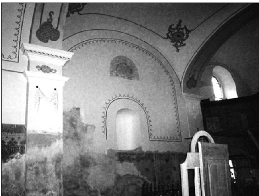
Původní stav výmalby poškozené vlhkostí
