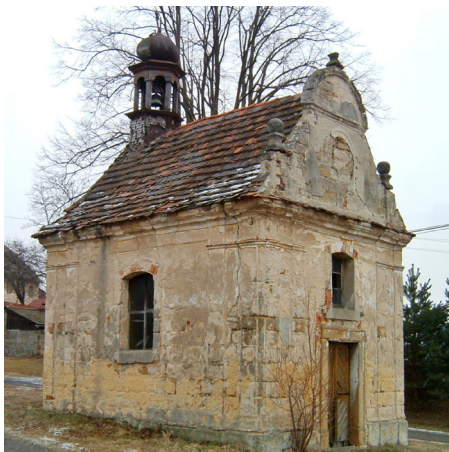
Stav před opravou z roku 2005
