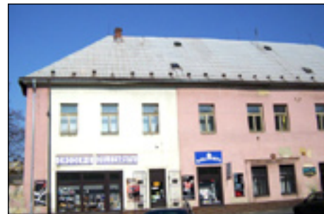
Nevhodná plechová krytina na čp. 192
