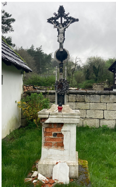
Křížek před opravou
