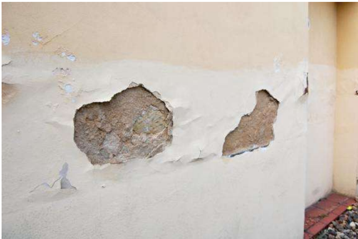
14) Modlitebna - poškození omítek 06/20
