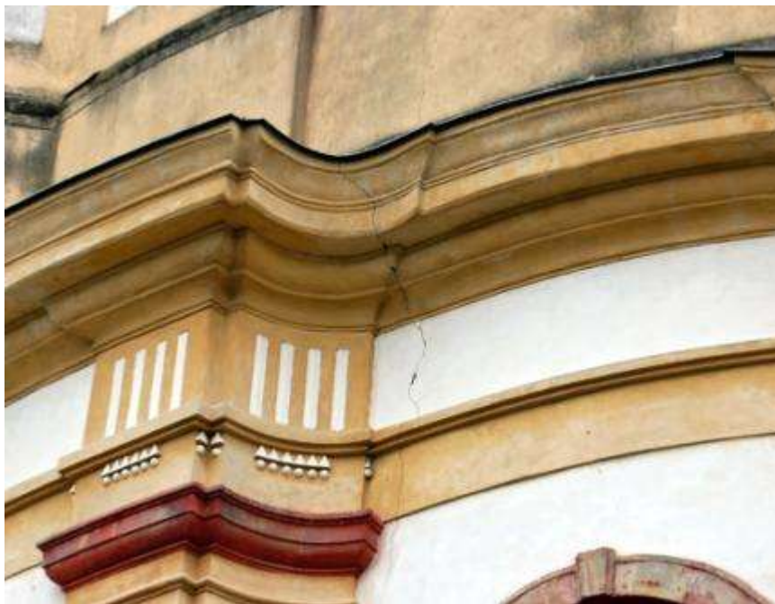
415) Prasklina v průčelí 07/20
