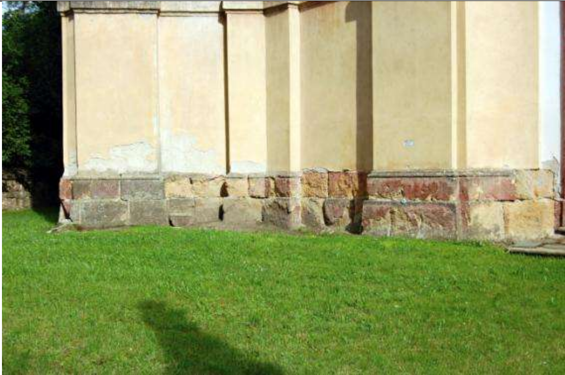
404) Poškození soklu kostela 06/20
