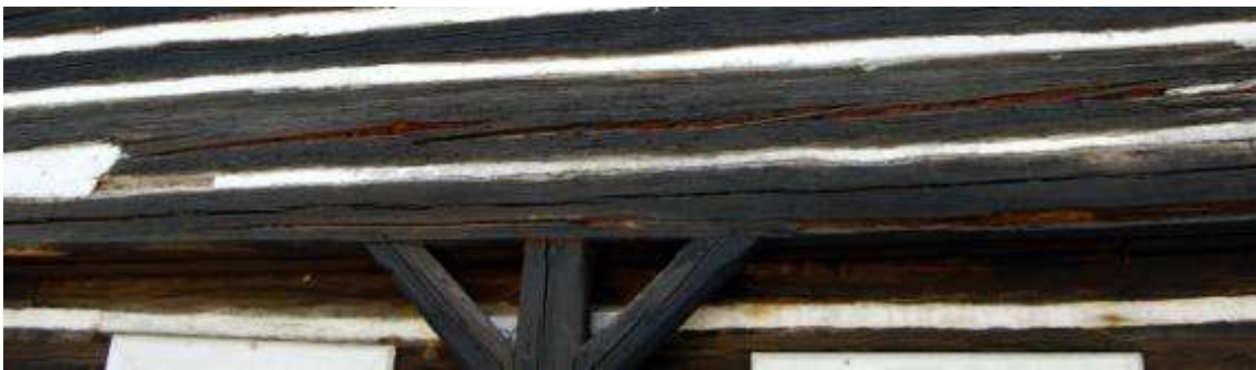
20) Detail vypraskaného trámu napadeného červotočem - pohled z Dlouhé ulice 06/20
