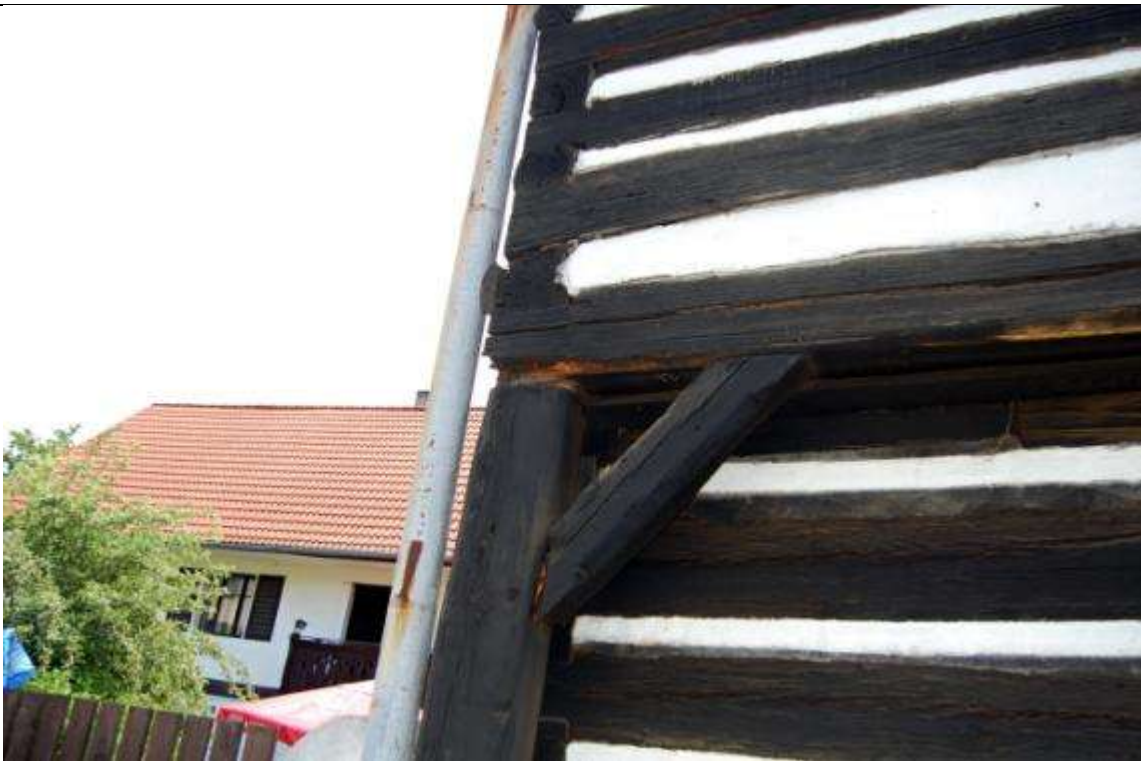
21) Poškozená podstávka - pohled z Dlouhé ulice 06/20
