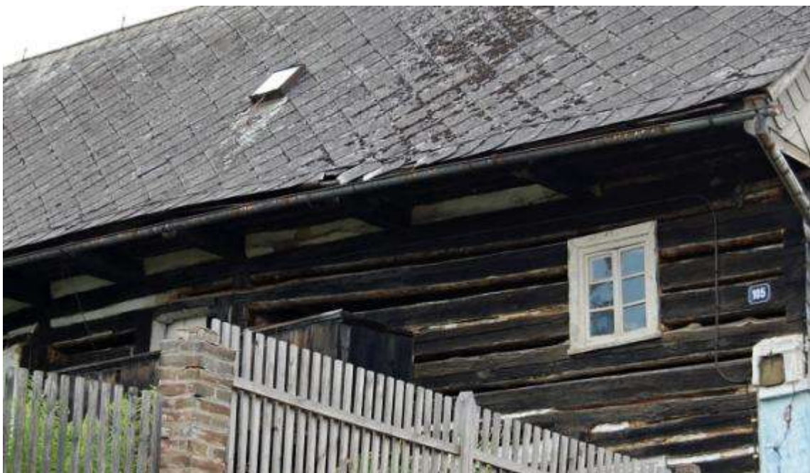
9133) Detail chybějící vymazávky 06/20
