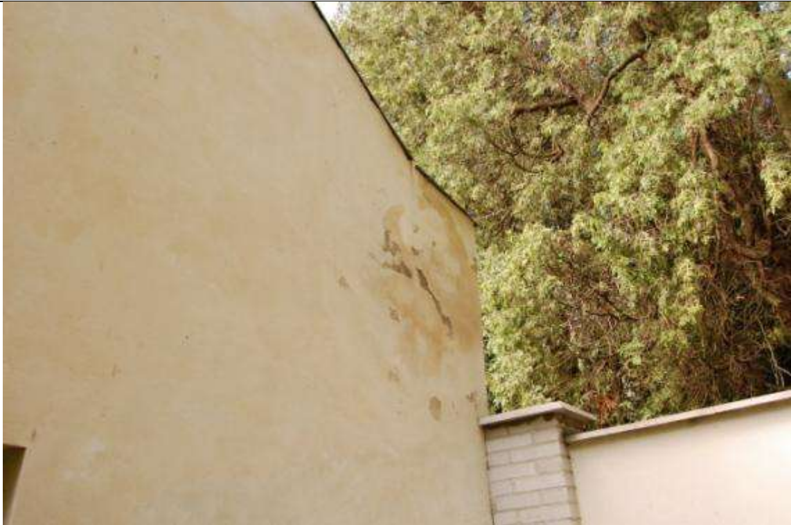
1247) Detail poškození v zadní části 07/20
