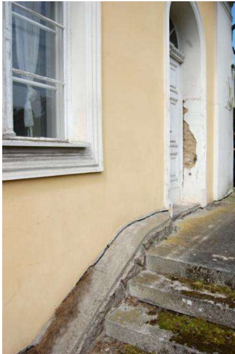
12) Modlitebna - detail popraskání schodiště 06/20
