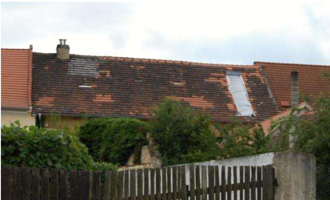
18) Střecha poškozená pádem komína - ze směru od Malé Strany 07/20
