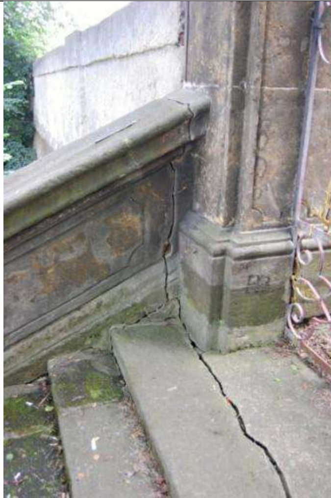
358) Detail poškození schodiště 06/20
