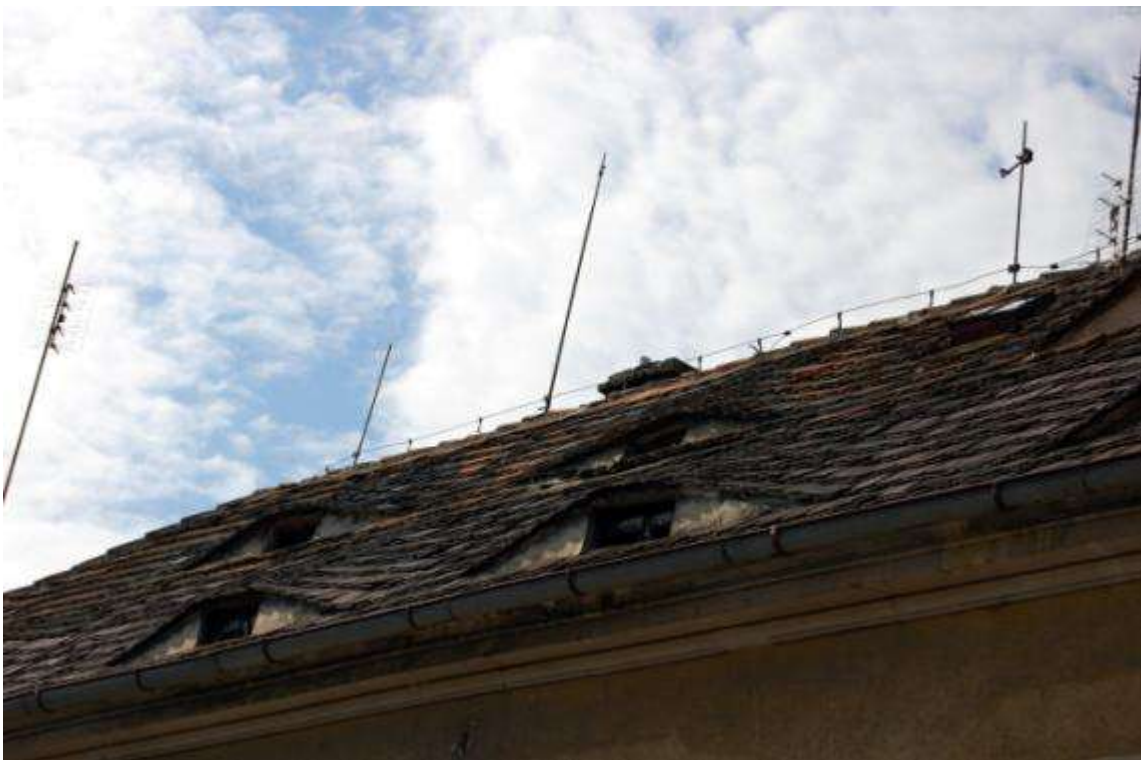
5) Detail střechy s propadlým "volským okem" 06/20
