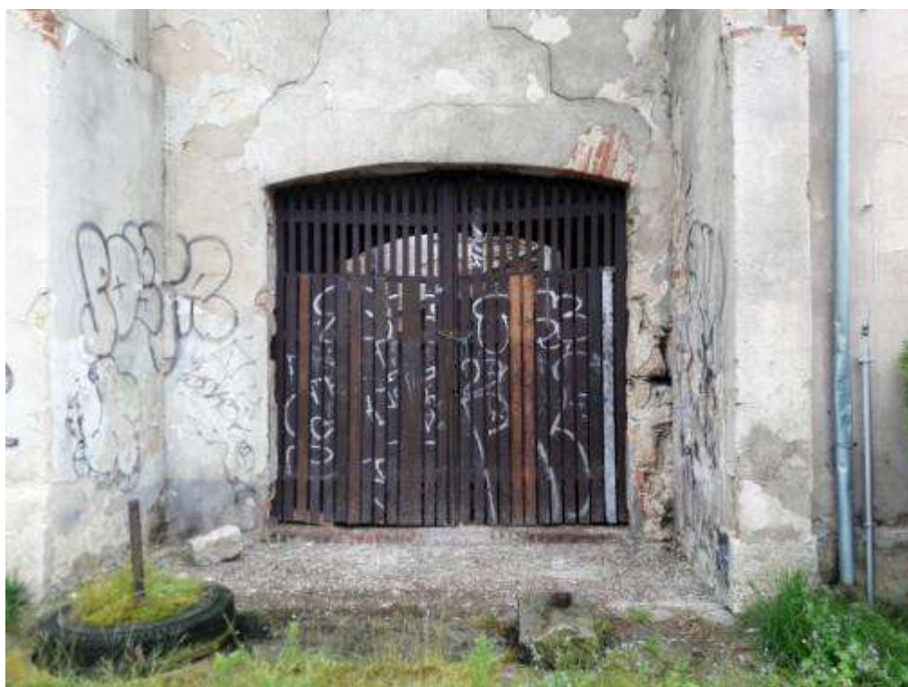
201) Zadní trakt s průjezdem poškozovaný vandaly 07/20
