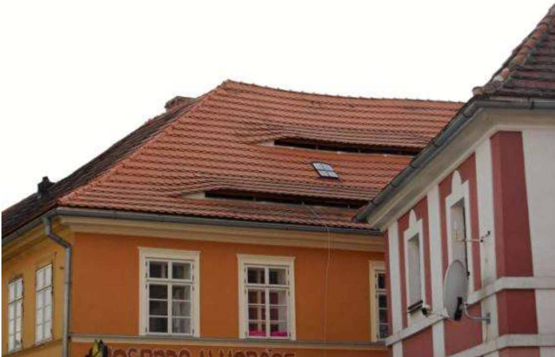
53) Pásové větrací škvíry - pohled ze Školní ulice 05/20
