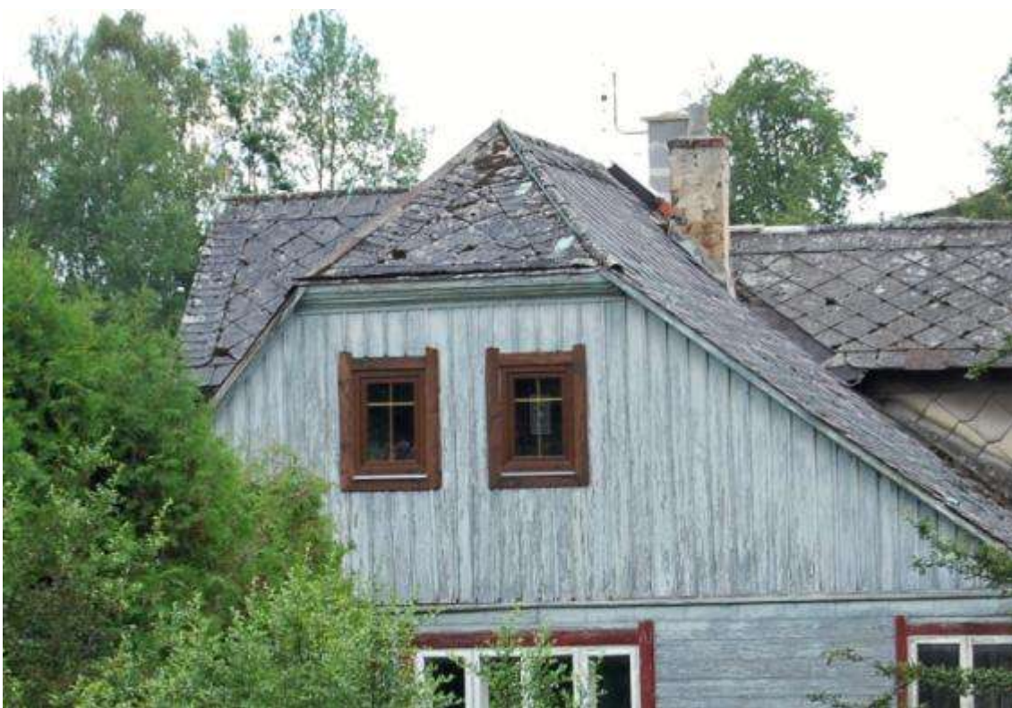
10951) Nevhodná okna - pohled ze Sadové ulice 07/20
