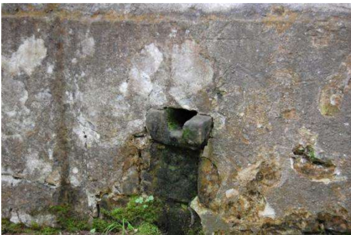
393) Odvodňovací systém areálu hřbitova 06/20
