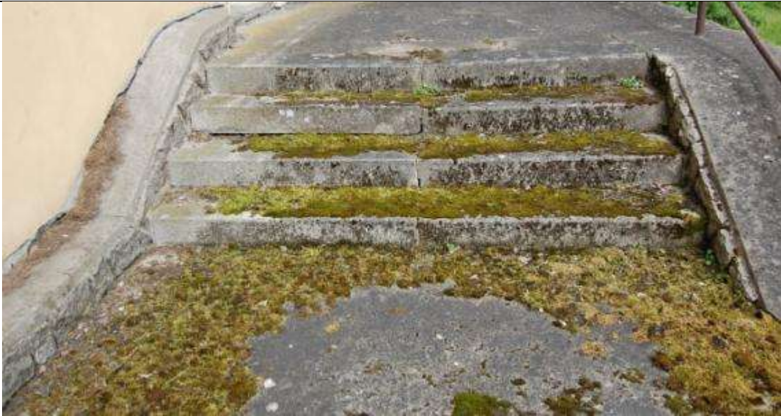
11) Popraskané schodiště u modlitebny 06/20
