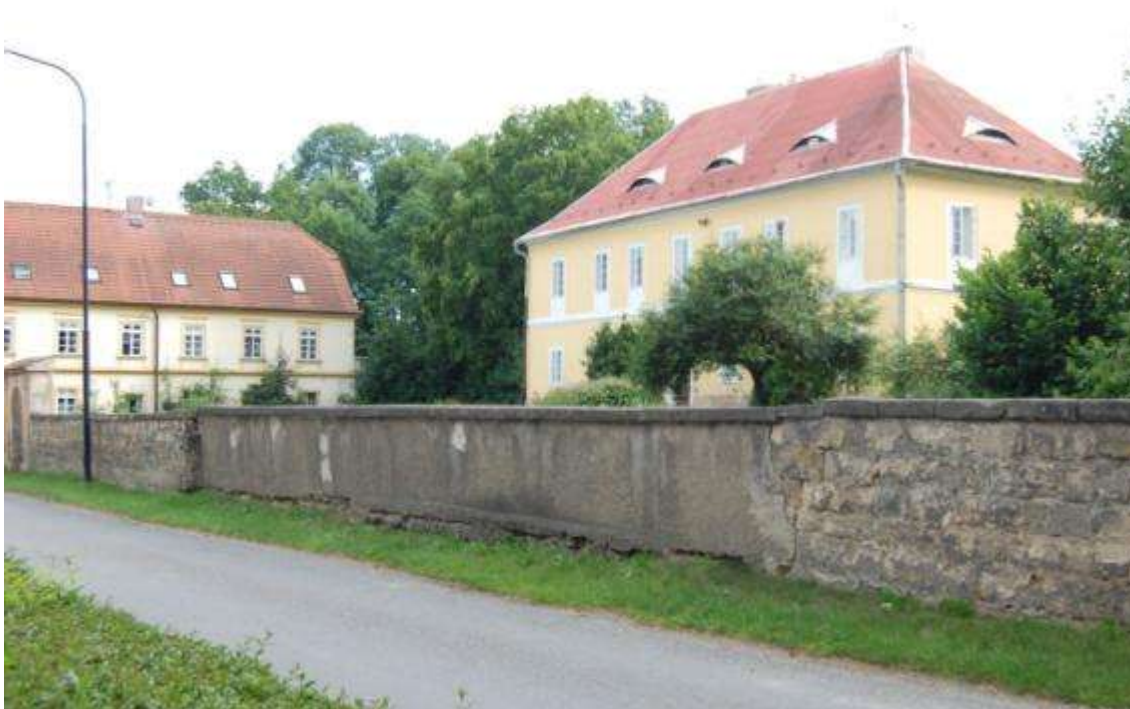
979) Nevhodná oprava ohradní zdi 06/20
