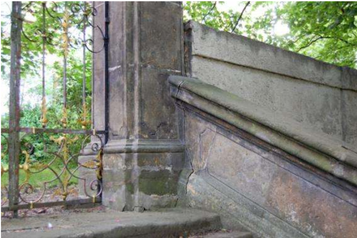
347) Detail poškození schodiště 06/20
