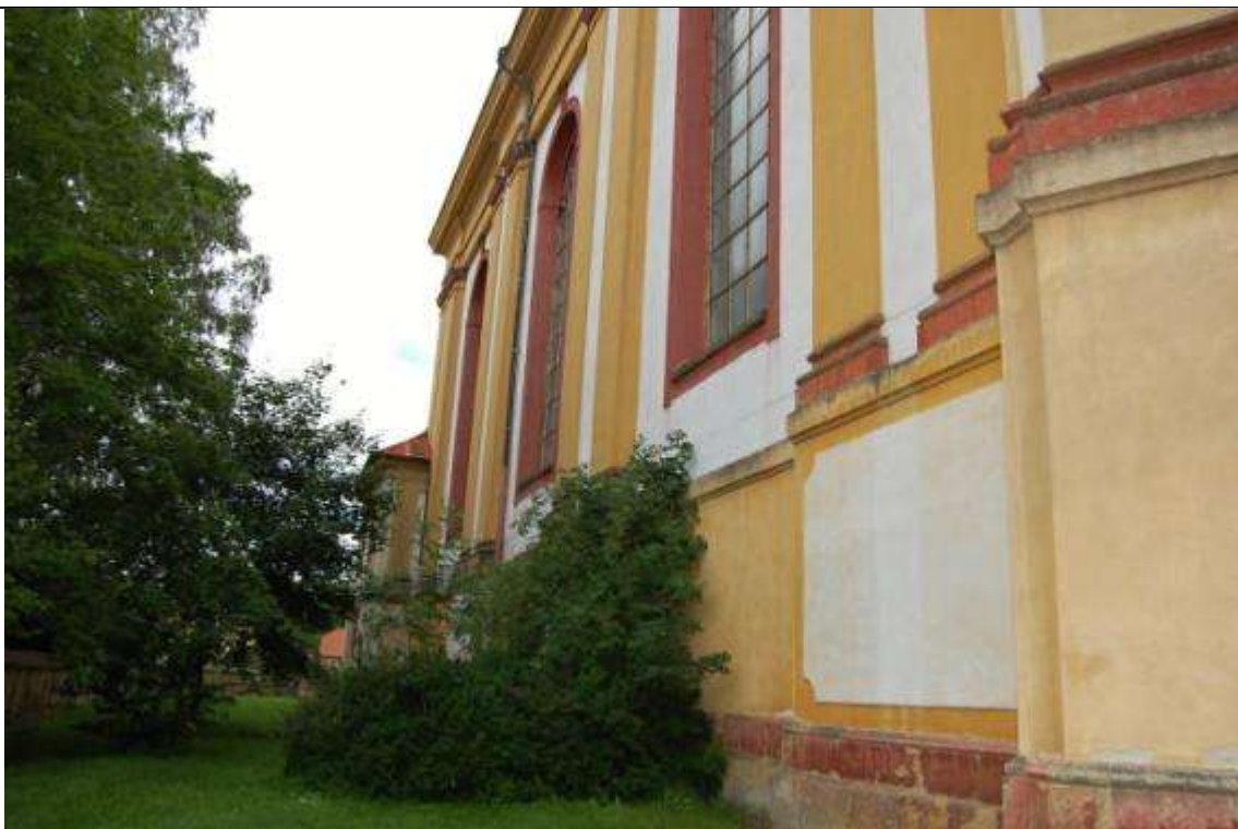
382) Náletové dřeviny u budovy kostela 07/20
